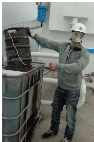
Рис. 2. Часть оборудования комплекса очистки высокотоксичных жидких отходов
