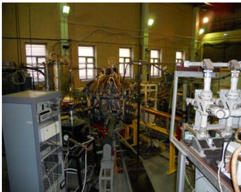
Рис. 38. Зал токамака «Глобус-М»
